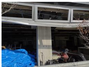
写真1 被災した雄勝総合支所
