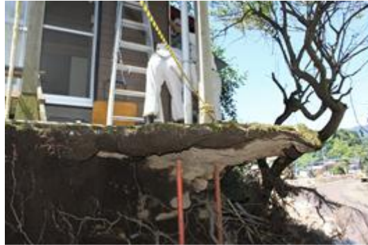
図6 護岸被害により地盤が流出し、大きく傾斜した住宅被害
