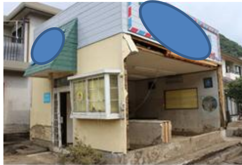
図7 1 階天井付近まで浸水。大量の土砂と倒木を巻き込んだ濁流により店舗の半分が流出
